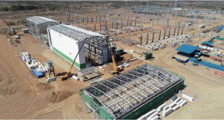
肯尼亚西门子高压输变电站
